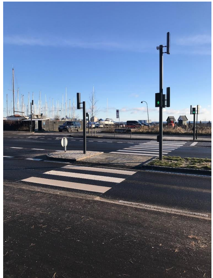
Nyt signalanlæg ved havnens sydligste til- og frakørsel.
