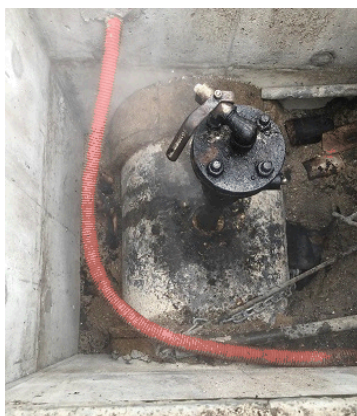
Billede af den utætte svejsning, der var årsag til nedlukning af transmissionsledningen. Foto: GGF
